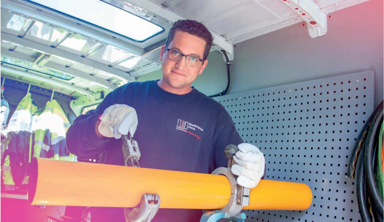
Kontinuierlich investieren wir in das sichere Netz und schaffen damit Versorgungssicherheit für Unna.
